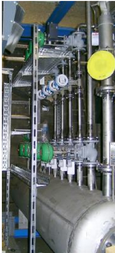
CO 2 -Rezierkulation Gasspeicher u. Regeleinheit
