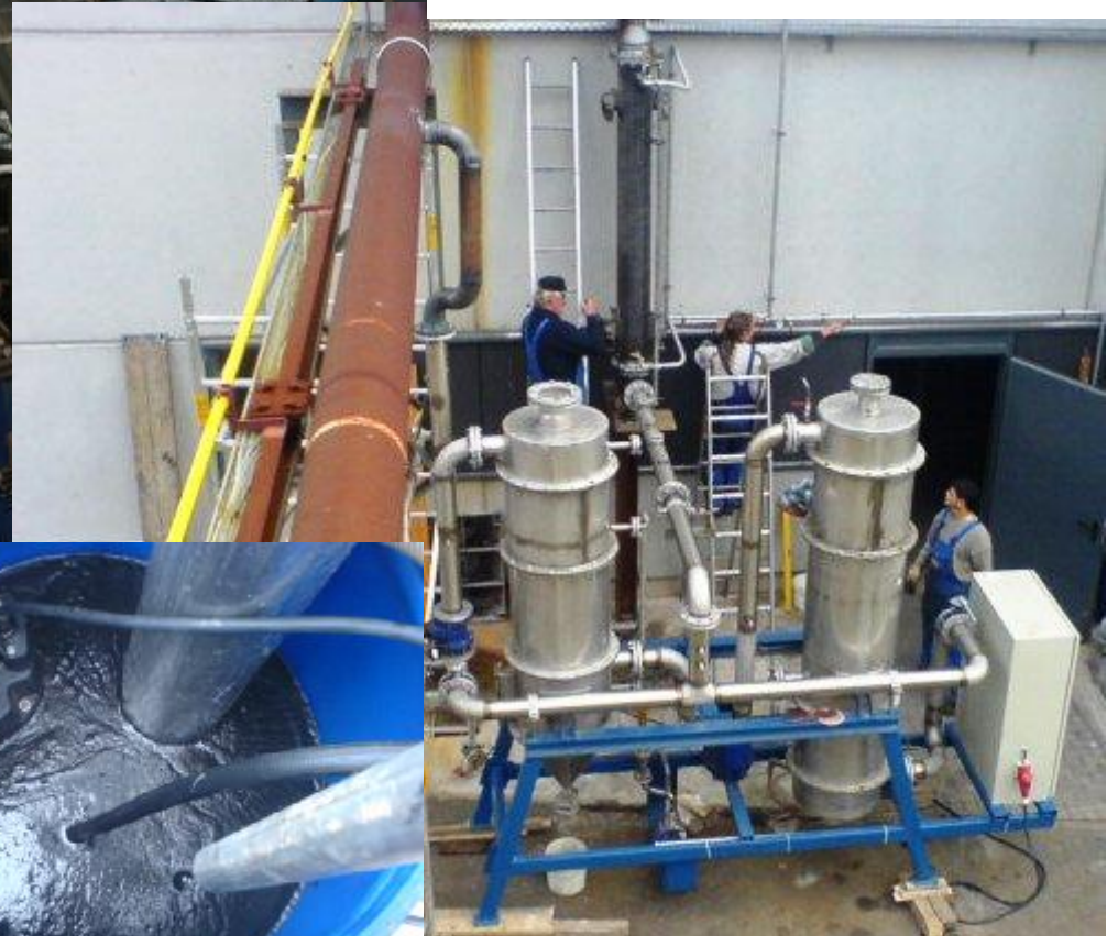
VER GmbH – Testanlage zur Brenngaskühlung und -reinigung
