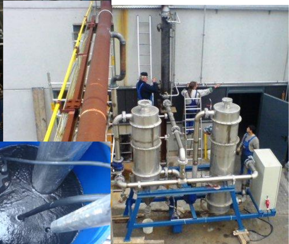
VER GmbH – Testanlage zur Brenngaskühlung und -reinigung
