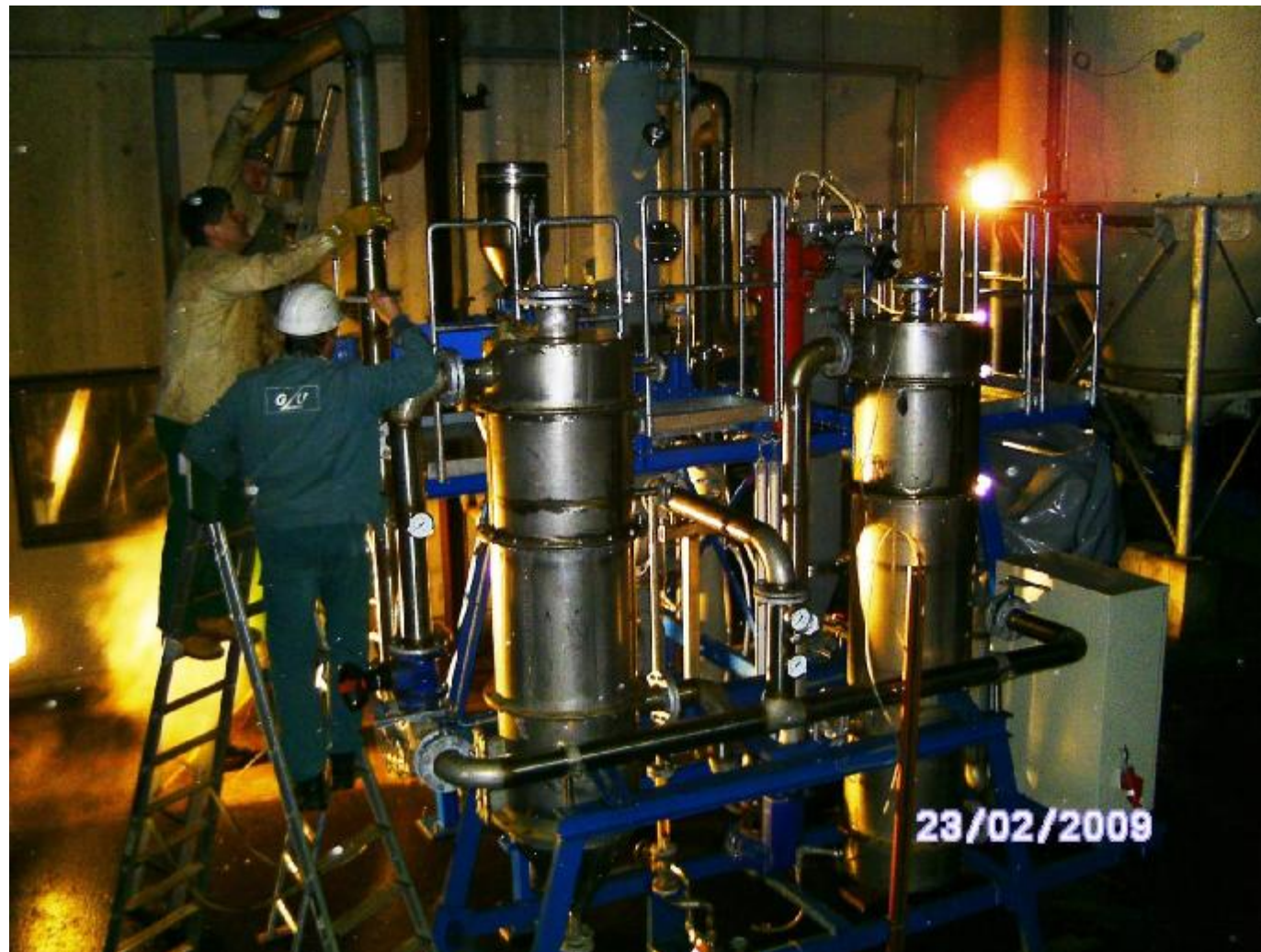
Anschluss der Testanlage an die Brenngasfackel
