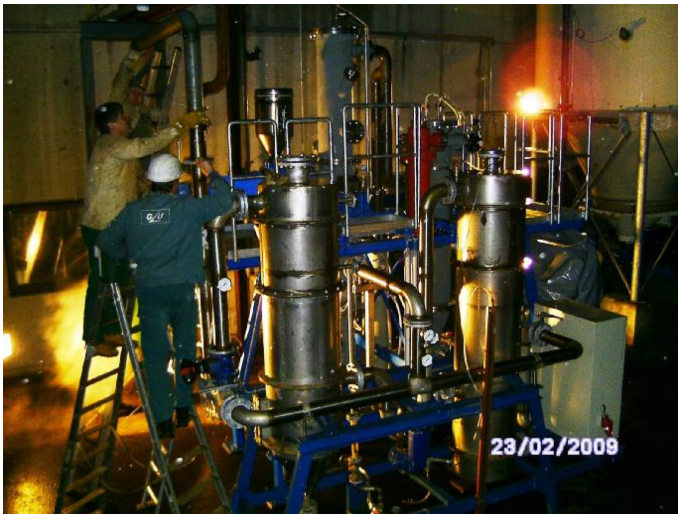
Anschluss der Testanlage an die Brenngasfackel
