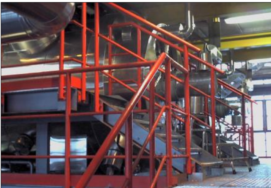
DFT ® -Trocknungsanlage bei SVZ Schwarze Pumpe
